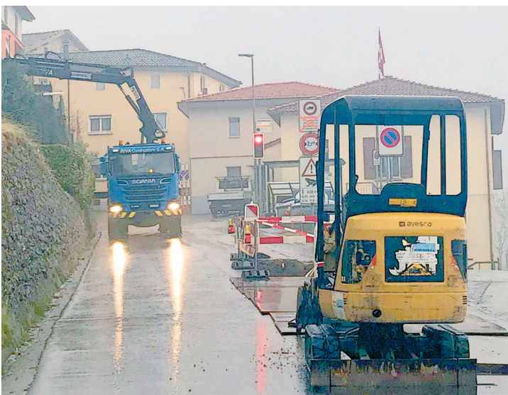
Nei giorni scorsi gli ultimi lavori di sottostruttura, da settimana prossima il Cantone comincerà ad asfaltare.
